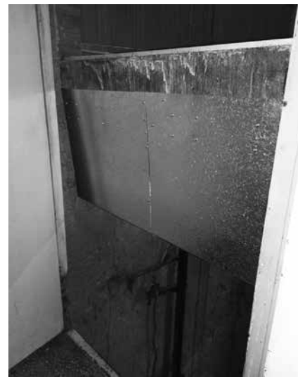
Ето така изглежда монтираният предпазен щит на асансьор
