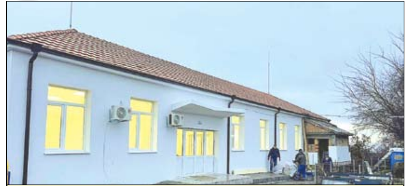
Тази седмица текат довършителните дейности по основния ремонт на читалището в с. Пещерско, което не е основно ремонтирано поне от половин век
