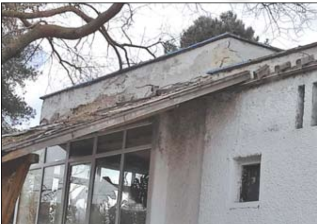
Покривът е с напукан и обрушен борд
